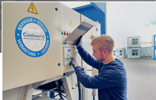
Qualifizierte Fachkräfte übernehmen Services wie Wartungsarbeiten
